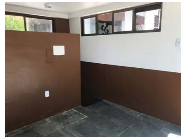
As obras para a modernização da Sala de Segurança junto à guarita já começaram.
